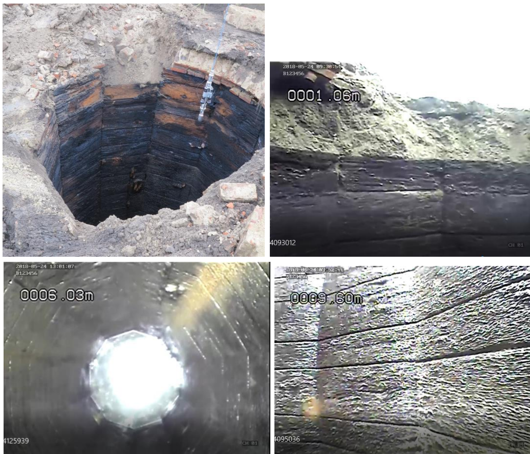
Figure 4 - Cuvelage en bois en partie haute : bon état général, forme décagonale, éléments jointifs, suintements et trainée ocre d'écoulement d'eaux chargées. (Photos UTAM Est)
